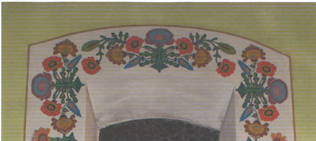
13. Zwieńczenie bordiury okna w prezbiterium- stan sprzed remontu 2012 r.
