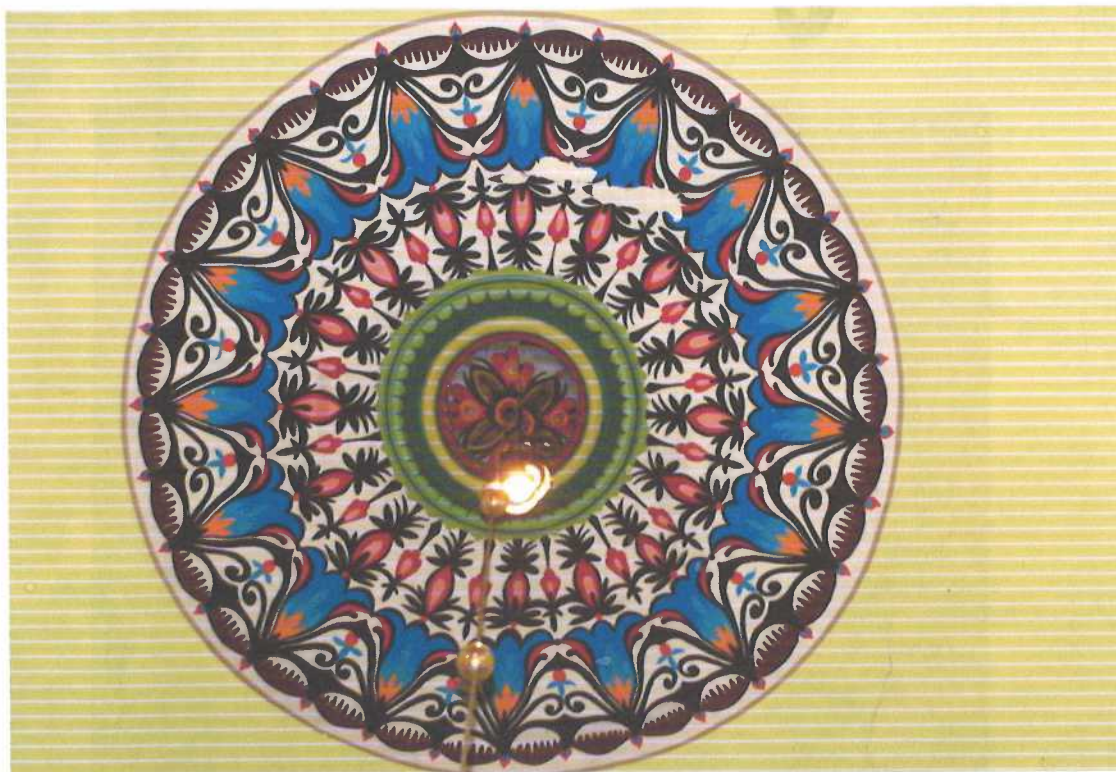
9. Rozeta duża na stropie nawy głównej- stan sprzed remontu 2012 r.
