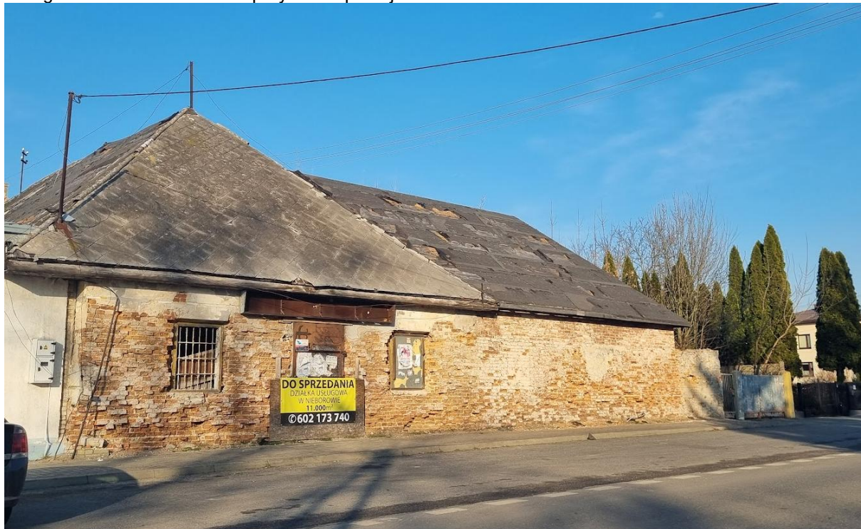
Fotografia 14. Stan obiektów przy Alei Lipowej
